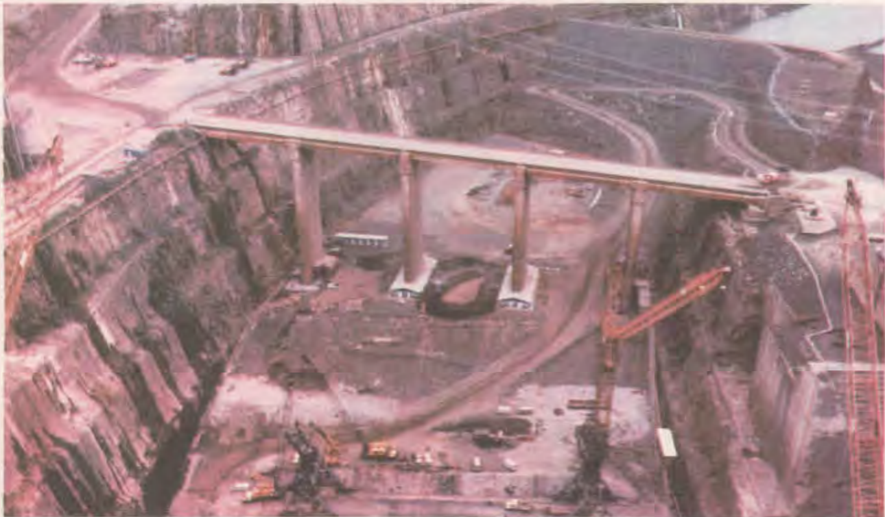
A fin de permitir la construcción de lo restante en la casa de máquinas, unidades 16, 17 y 18, fue necesario emprender la elevación de la ataguía existente en el antiguo canal de desvío. La fotografía de arriba, muestra esa obra, ya concluida, realizada entre enero y junio de 1986.
