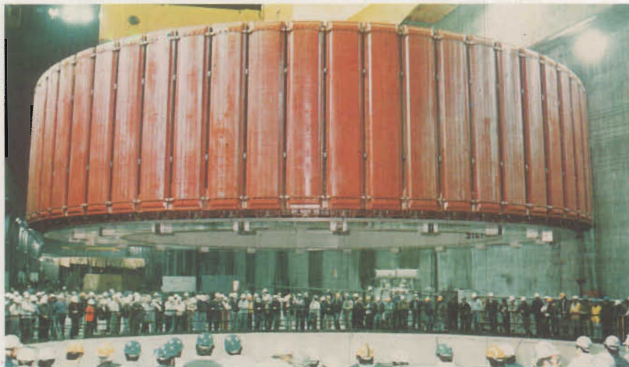
Descenso al pozo de la turbina de la unidad generadora No. 3, sector de 50 Hz.
