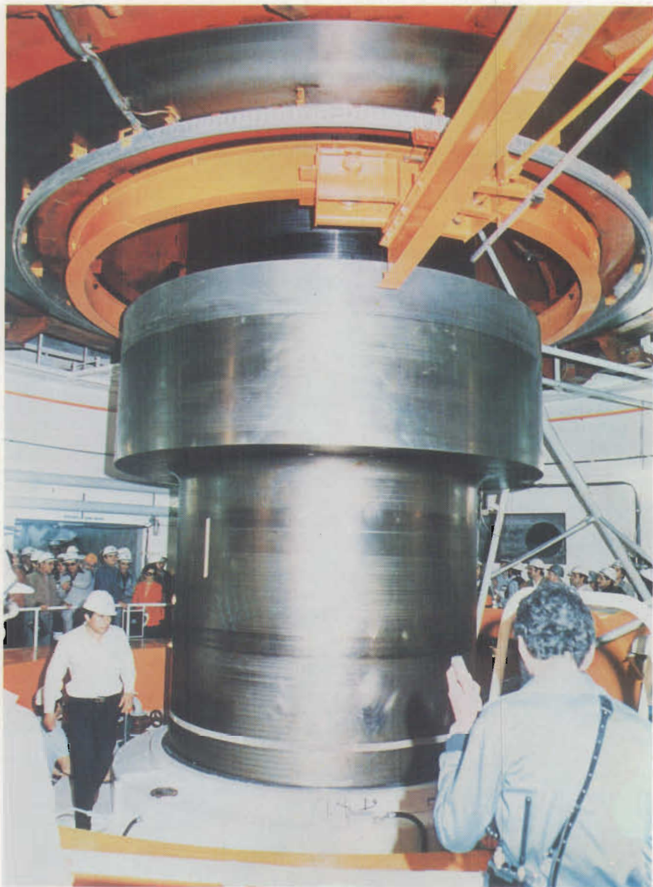
Momento en que la unidad generadora No. 2 ejecuta, con éxito, su primer giro mecánico, el 27 de setiembre de 1984.
